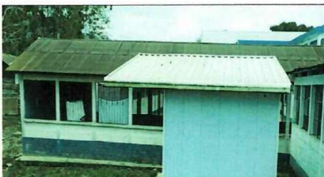
Foto 3: Lado Sur del edificio cuando no se ha dado el mantenimiento
